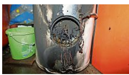
Der ausgebrannte Boiler.
