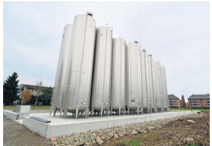
Stehen provisorisch im Freien: Die 15 Stahltanks sind bereits zur Hälfte mit Saftkonzentrat gefüllt. Das Projekt eines Tankgebäudes ist blockiert.
