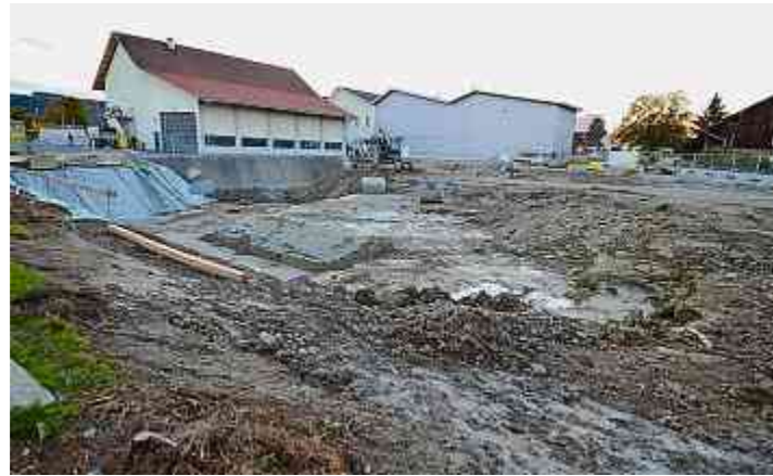
Baustelle im Stachener Zentrum bei der Mosterei Möhl: Der Aushub für den kombinierten Neubau ist im Gange. Bild: Max Eichenberger
